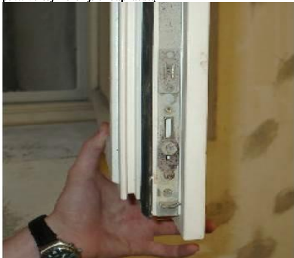
3 pav.: Baltoji korozija ant apkaustų
