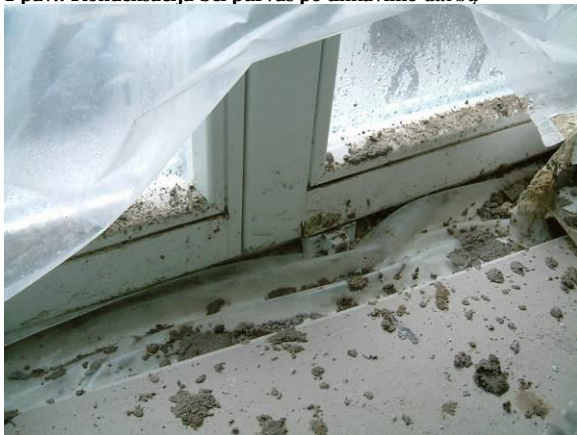
1 pav.: Kondensacija bei purvas po tinkavimo darbų
