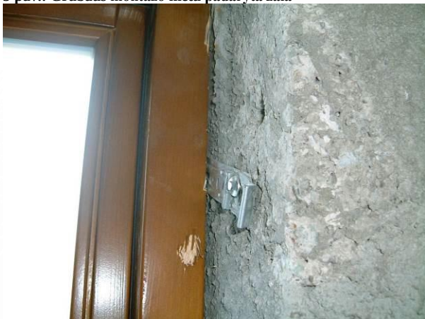
5 pav.: Grubaus montažo metu padaryta žala
